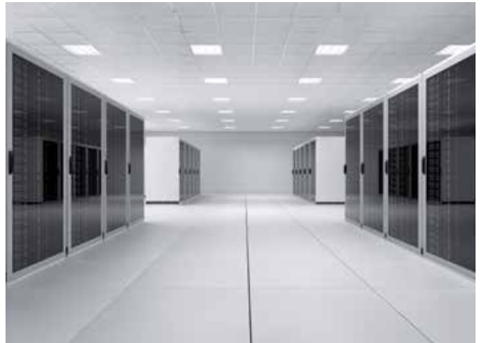
Data Centers - Centres de Traitement de Données
