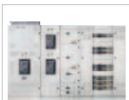
Équipement basse tension
